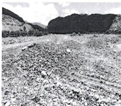
FOTO 03: ÁREA DE INTERVENCIÓN EN LA QUE SE APRECIA LA OCUPACIÓN DEL CAUCE DEL RÍO CACHI CON MATERIAL DE DESCARTE (OVER)
