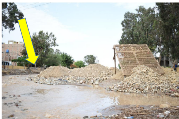
Foto N°04: Material zarandeado y de descarte en el cauce del río (Curso del río desviado).
