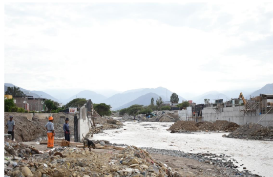
Foto N°02: Muro de encauzamiento con filtración del río.
